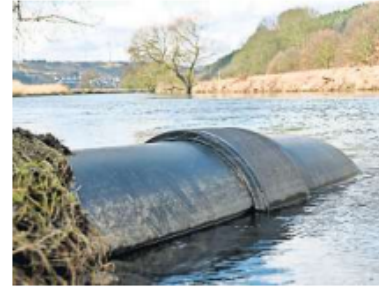
Ein Einleitungsrohr für Salzabwasser am Ufer der Werra in Philippsthal in Hessen.
