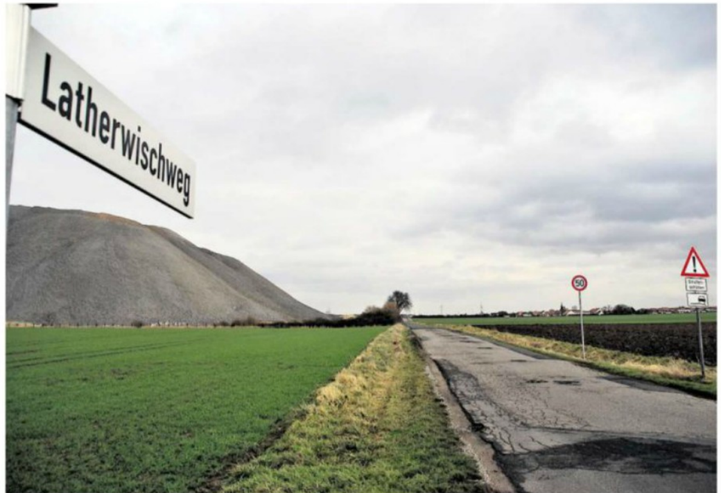
Der Latherwischweg, Teil der Zufahrt zum Kalibergwerk, ist in einem schlechten Zustand. Nun gibt es Streit darüber, in welchem Ausmaß diese und andere Straßen ausgebaut werden sollen.
