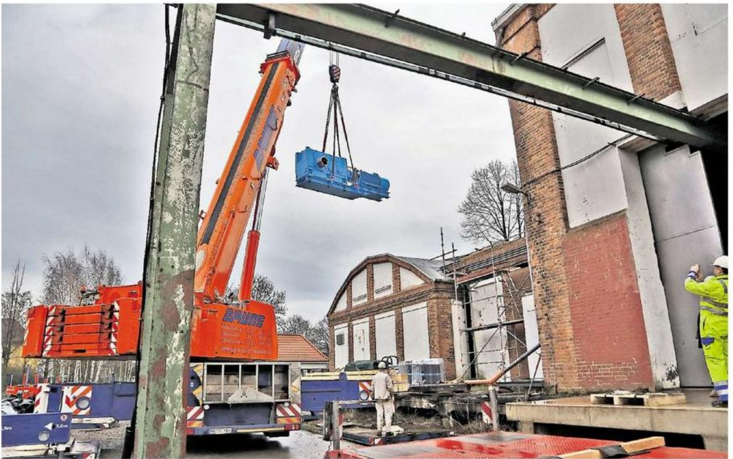
Per Kran wird der 30-Tonnen-Motorblock in das Schachtgebäude Fürstenhall bei Ahrbergen durch das geöffnete Dach eingehoben.
