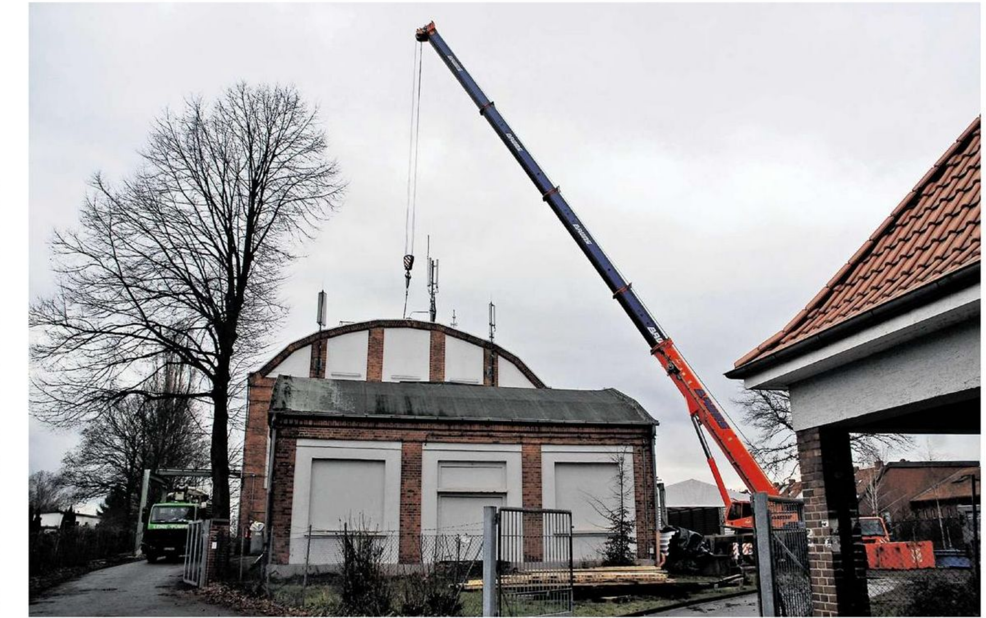
Das Schachtgebäude Fürstenhall in Ahrbergen wird derzeit für eine Wiederaufnahme des Betriebs vorbereitet. Es ist geplant, den Schornstein auf eine Höhe von 19 Metern zu erweitern.
