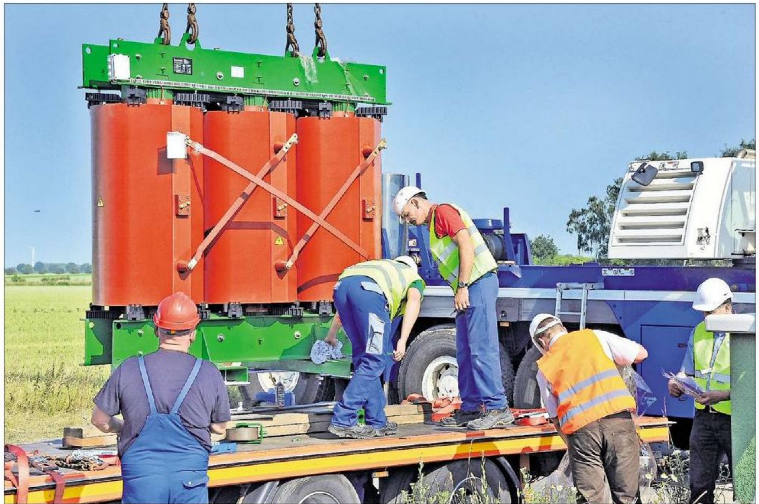
Eine von zwei Trafostationen, die künftig mehr Strom für den Kalibergbau Unter Tage liefern soll.
