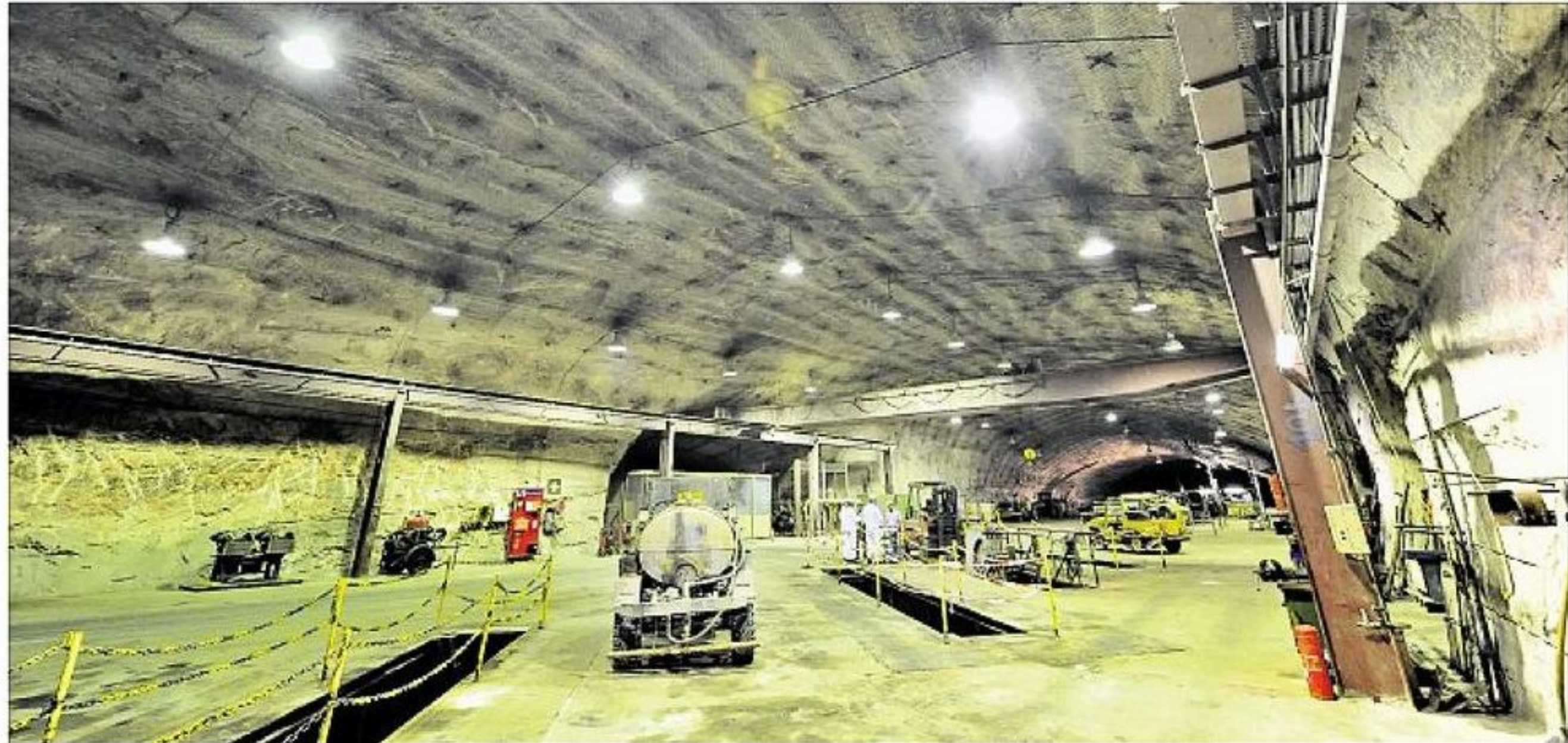
Maschinen- und Fahrzeughalle unter Tage: Auch wenn in Siegfried Giesen seit 1987 kein Kali mehr abgebaut wird, bleibt die Anlage technisch in Betrieb.
